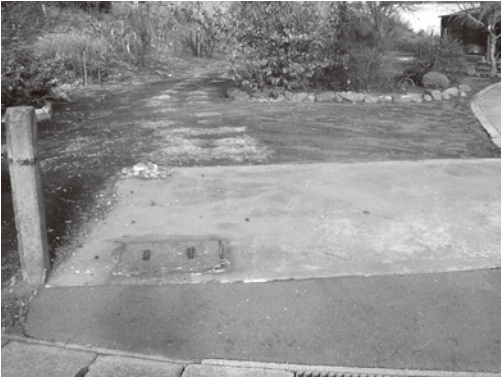
民有地に設置された防火水槽
